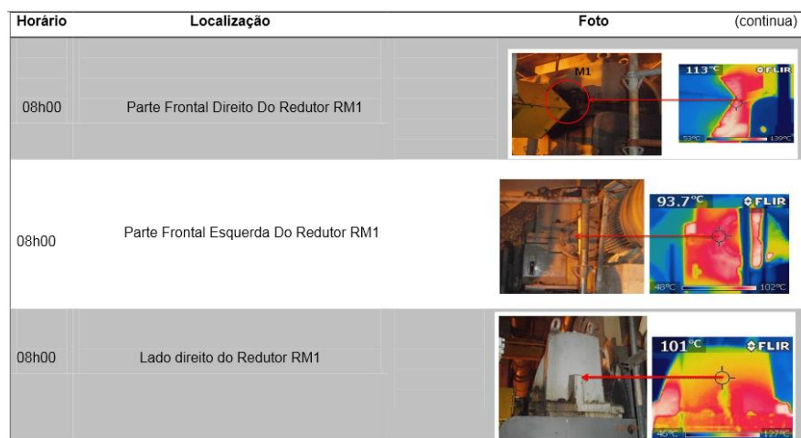
Figura 02. Análise termográfica de um redutor em regime de trabalho (Quartezani et al, 2013).
