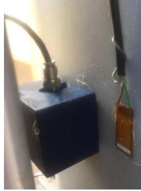
Figura 3. Instalação dos sensores na parede do transformador.
