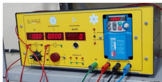
Figura 7 - Controlador de frequência do túnel de vento (Autores, 2025)
