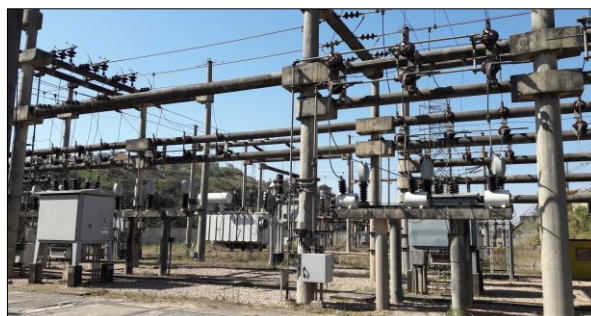
Figura 4. Subestação de Francisco Morato da CPTM na região metropolitana de São Paulo
