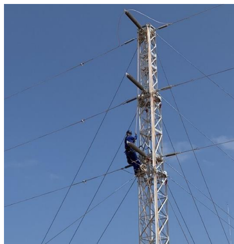
Figura 13. Torre de Emergência na configuração de ancoragem em angulo
