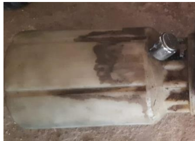
Figura 3.1 - Vazamento no reservatório. Acervo próprio (2021)
