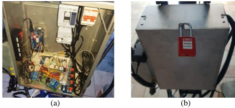
Figura 3.3. Quadro de comando: (a) componentes no interior do quadro e (b) Quadro de comando.
