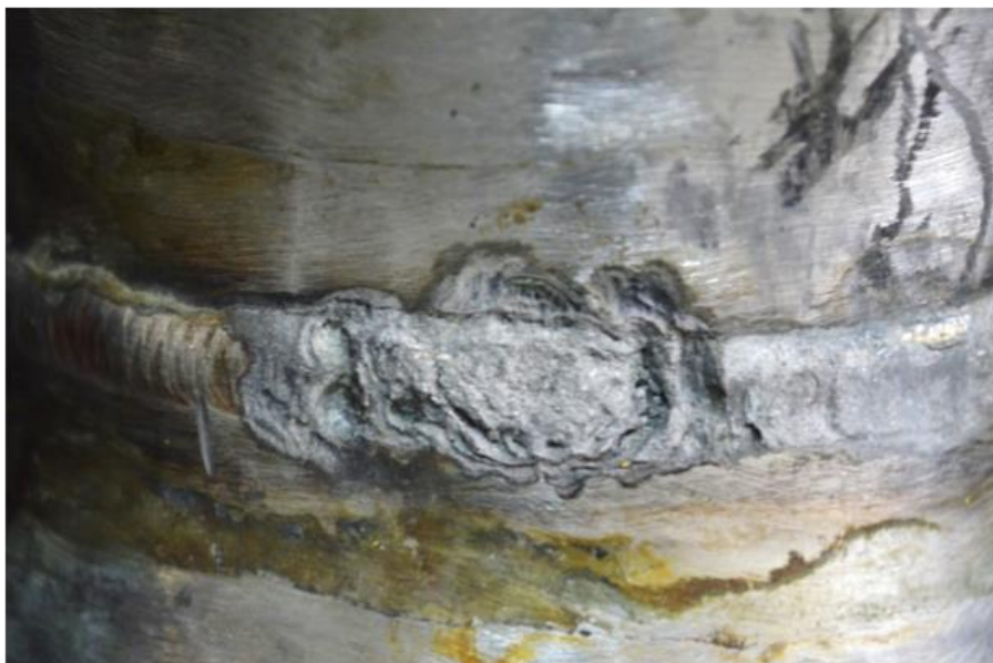
Figura 2. Perfuração provocada por corrosão na solda de emenda de tubo em AISD.
