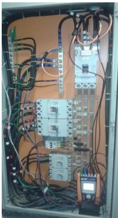
Figura 2. Analisador instalado em quadro de força
