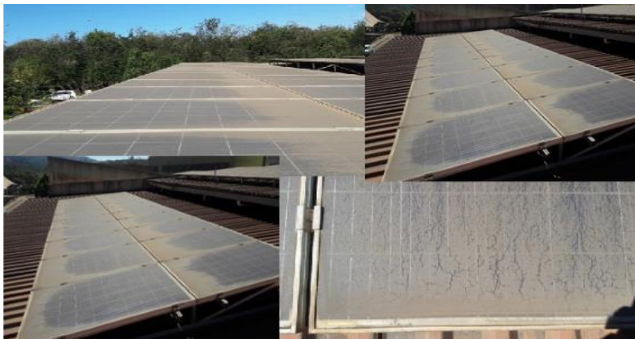
Figura 2: Módulos antes da manutenção. Fonte: alsol energias renováveis
